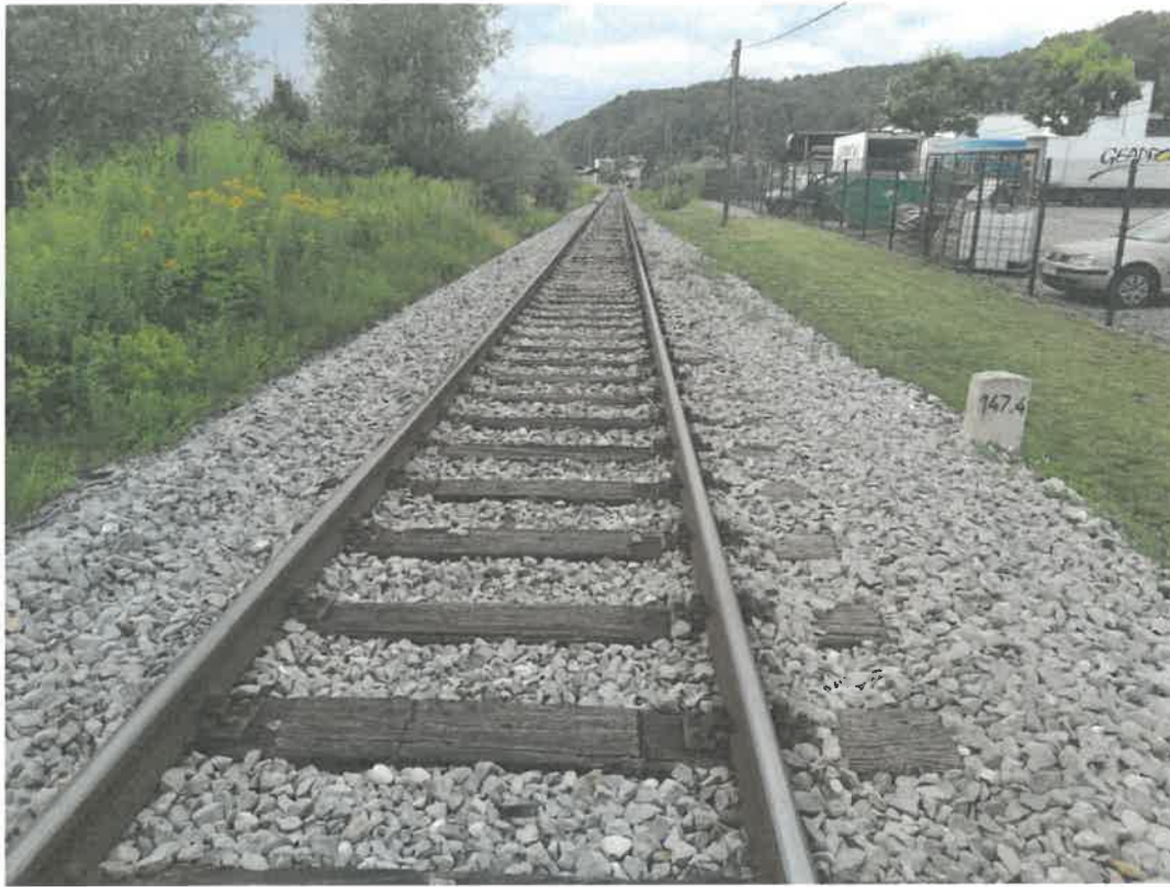
Slika 6: Širše območje predvidenega novega postajališča Ljubljana Rudnik (pogled v smeri Ljubljane) – v km 147+569 nivojski prehod Semenarna
